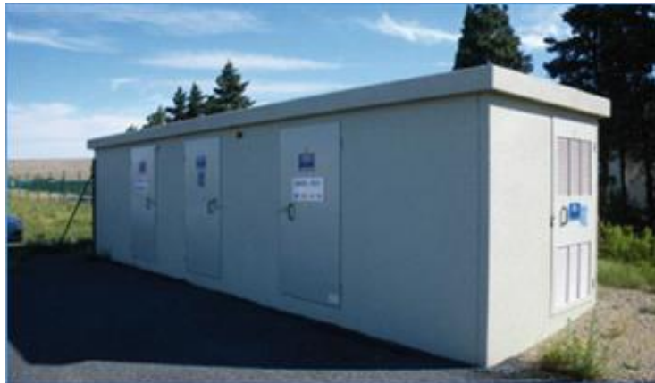
Figure 30 : Exemple de poste de transformation
