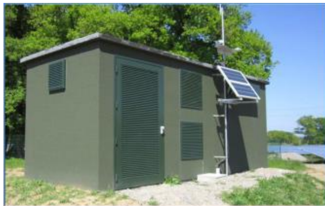
Figure 31 : Poste de livraison
